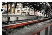
Impianto di ossidazione, Pineto (Te).
