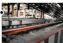
Impianto di ossidazione, Pineto (Te).
